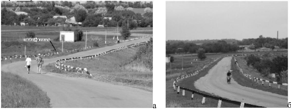
Рис. 1 – Вигляд дамби Великомихайлівського водосховища: а – в травні 2011 р; б – в жовтні 2013 р. Добре видно розвиток процесів просідання та сповзання ґрунту по положенню дорожнього відбійника
