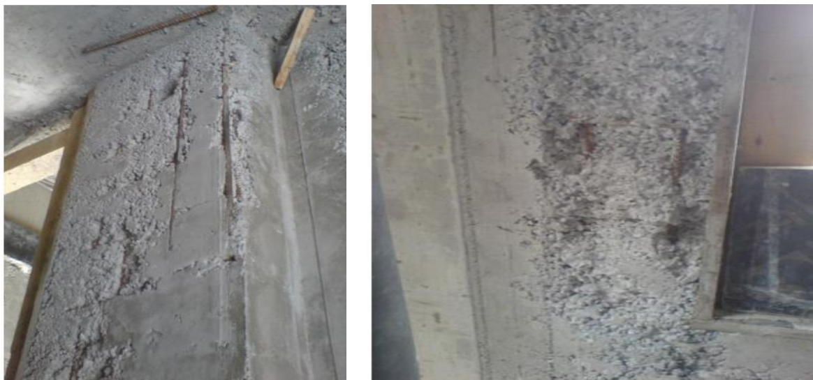
Рисунок 1– Примеры выявленных дефектов в колоннах 5-го этажа
