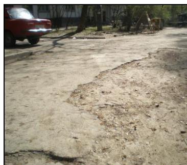
Рис. 2. Незадовільний стан дорожнього покриття
