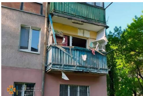
Рисунок 1 – Руйнування не капітальних та не несучих конструкції приміщень квартири у результаті вибуху природного газу
